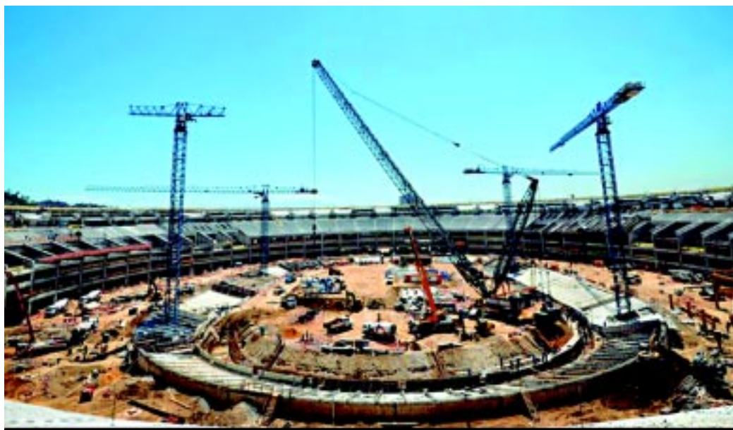
Obras de reforma do Estádio do Maracanã para o Mundial de 2014 estão em ritmo acelerado
